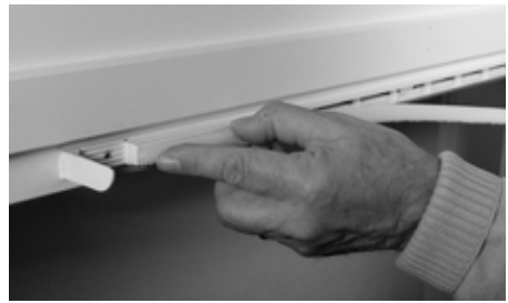
THERMOMAX VENTTIILIN SUODATTIMEN VAIHTO
